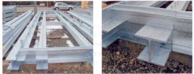
Abb. 5: Verzinkungsschaden an der steifen Rahmenkonstruktion eines Balkons infolge eines hohen Spannungsniveaus beim Verzinken durch «Doppeltauchen»
